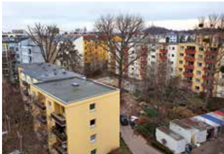
Die Gebäude der Wohnanlage im Wedding aus mehreren Baujahren von 1960 bis 1980 zeigen altersbedingten Sanierungsbedarf.
