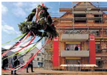
Mit der Fertigstellung des Rohbaus der vier neuen Häuser war im März 2021 ein wichtiges Etappenziel erreicht.
