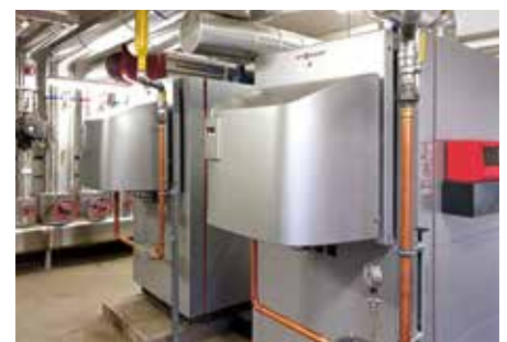
Im Bestand wurden mehrere Heizungsanlagen erneuert, wie diese Doppelkesselanlage mit Gasbrennwerttechnik in der Köpenicker Bahnhofstraße.
